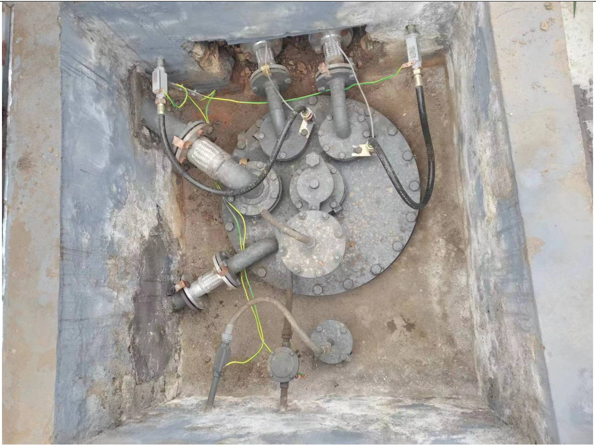
人孔盖上的接合管与引出井外管道的连接已采用金属软管过渡连接
